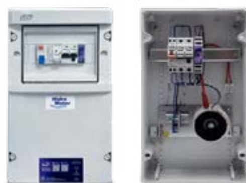
Gain de place dans le coffret électrique
